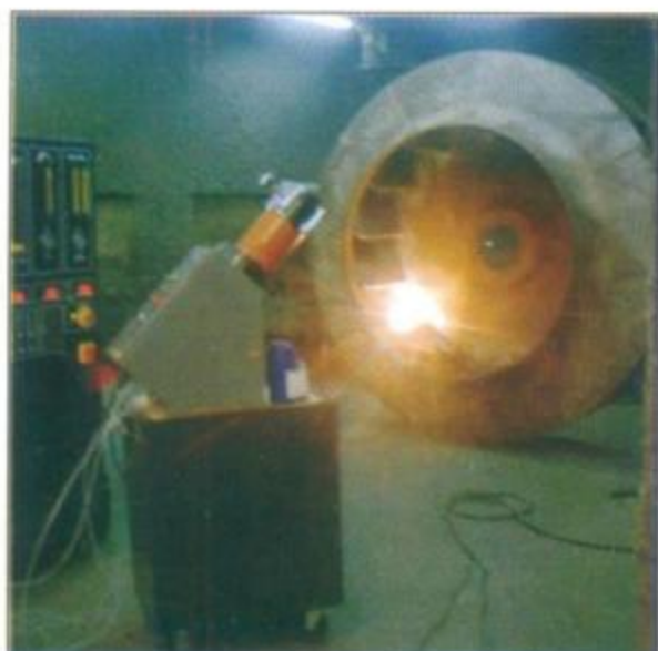
Revestimento em rotor de exaustor.
