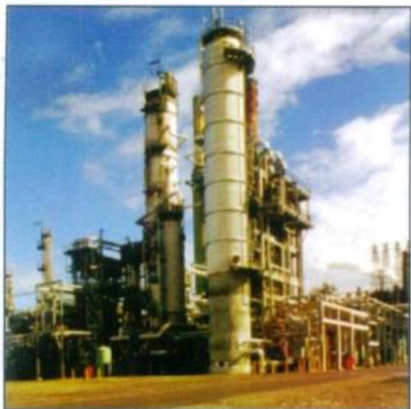
Revestimento em estrutura de torre de resfriamento e trocadores de calor serviço em campo.
